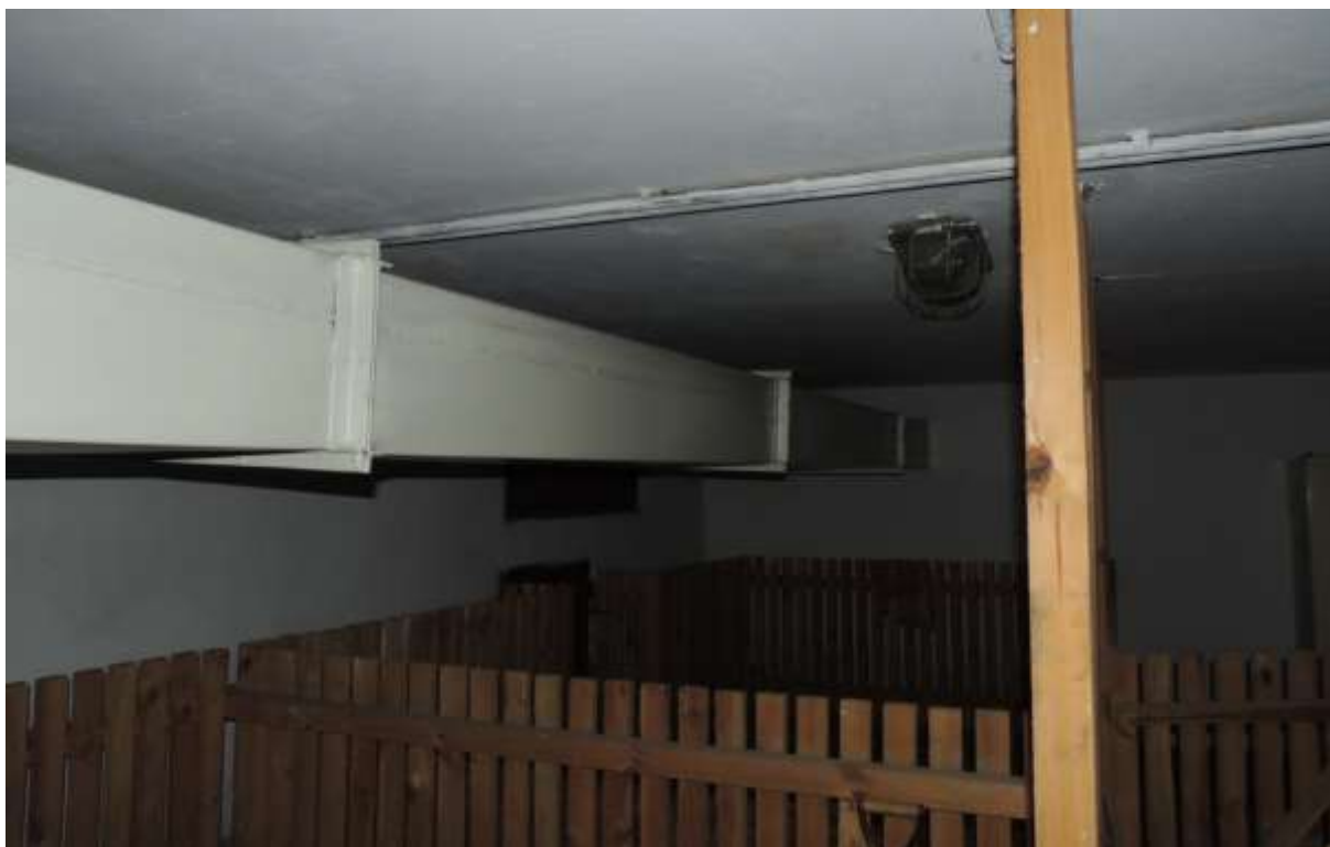
Fot.4 . Wnętrze jednego z pomieszczeń piwnicznych w Szkole Podstawowej nr 1 im. Stanisława Staszica w Szamotułach.
