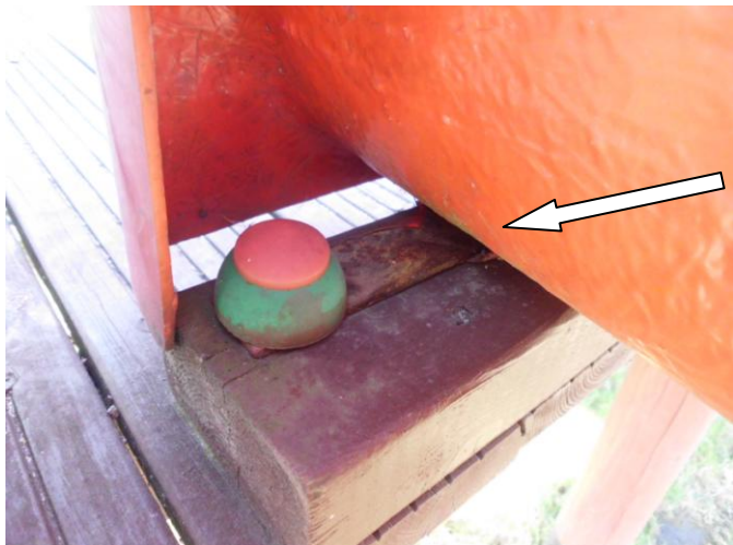
Korozja mocowania zjeżdżalni
