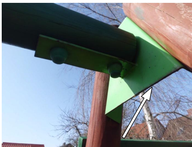
Korozja stalowych elementów drabiny
